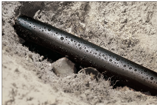
Tubería de pared gruesa.
